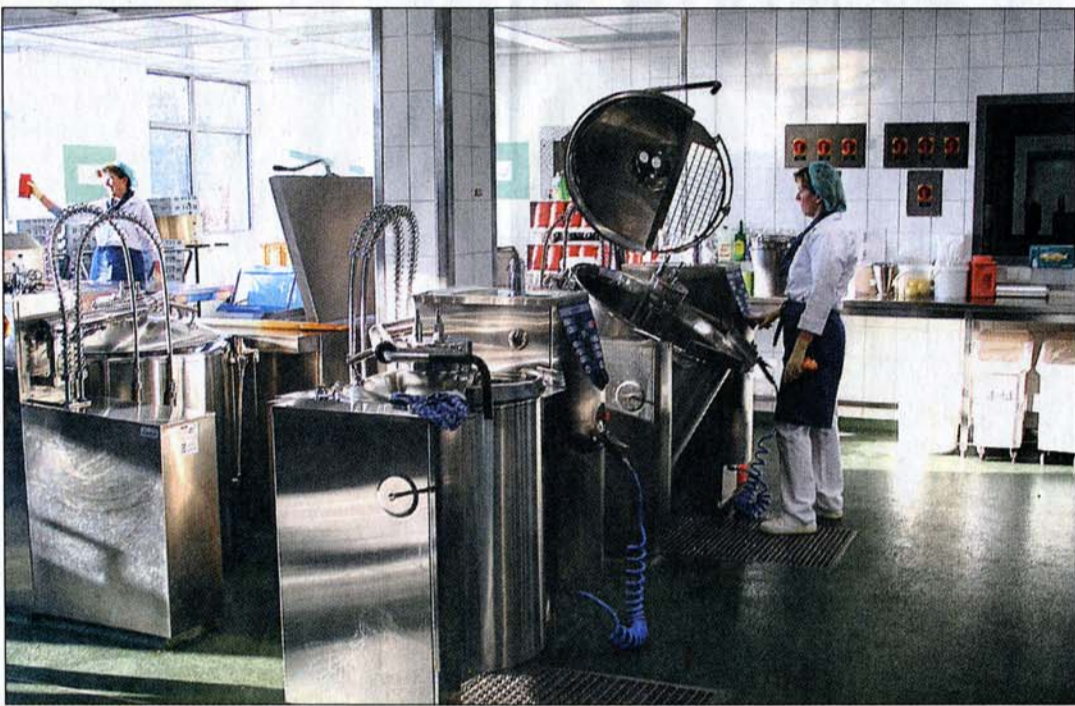
IM UNTERGESCHOSS DES GEBÄUDES werden die Speisen vor- und zubereitet sowie rückgekühlt.
