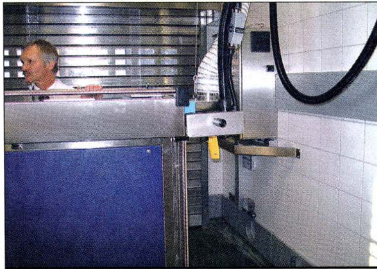
BEI DER BEFÜLLUNG DER WÄGEN wird überschüssige Kohlensäure gleich abgesaugt, sodass diese nicht in den Raum austreten kann.
