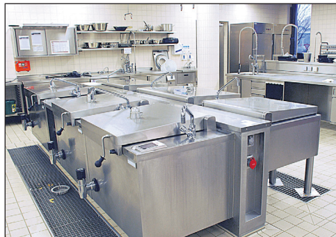
Im Frankfurter Tower 185 erfolgte die Ausführungsplanung des Betriebsrestaurants mit Küche durch Lacher Großküchen. Die Groß- und Banquetküche erhielt u. a. Kochblöcke mit Bratpfannen und Druckkochapparaten sowie zwei Multifunktionskochgeräte und einige Kombidämpfer, Großfritteusen sowie Trockendampfschnellgarer. Foto: Lacher
