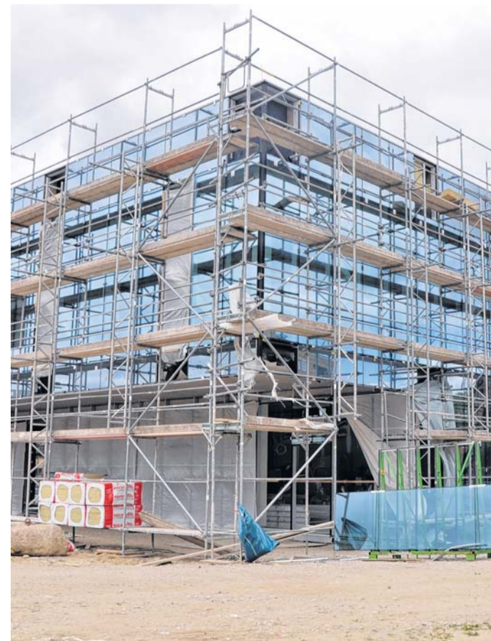
Kaum zu glauben: In vier Monaten soll hier Greifswalds größte Küche an den Start gehen. Ins nahe Klinikum kommt das Essen per Versorgungstunnel.
